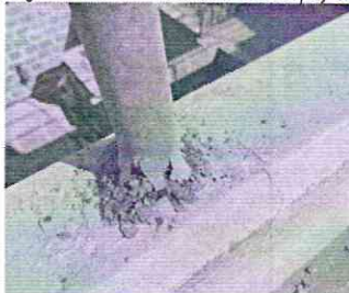
Imagen 01: Impacto de la humedad en la zona del proyecto en el fierro negro existente.
